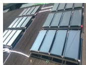
VT 태양열 설치
