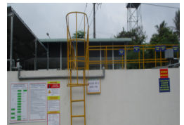
VT 폐수 재이용을 목적으로 설치된 미니 폐수처리장
